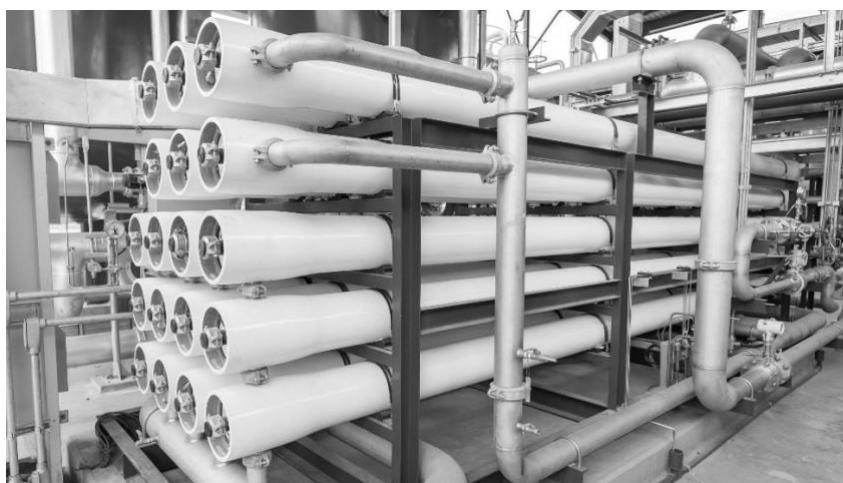
Figura 2.5 - Exemplo de sistema com membranas de osmose reversa
